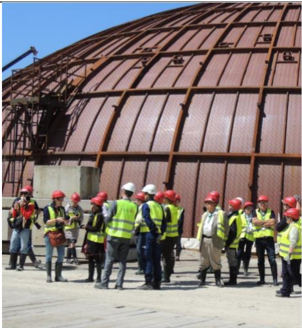
Juin 2013 – Le dôme métallique est prêt à être monté après sa construction au sol.
