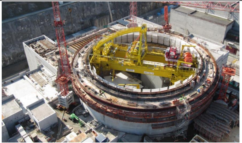
Juillet 2013 – Le pont polaire est entièrement monté. On voit en jaune les chariots lourd et léger définitifs et en rouge les chariots provisoires qui seront démontés après la mise en place des éléments électromécaniques dans le BR
