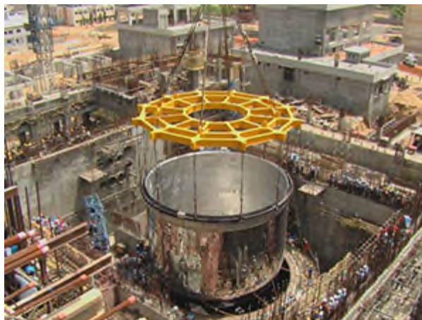
Figure 3 : réacteur indien PFBR (Prototype Fast Breeder Reactor). Etat du chantier en octobre 2004. Achèvement prévu en 2015.
